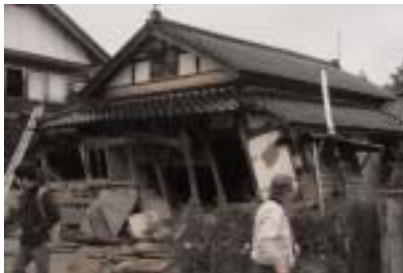
写真-1 多くみられた傾いただけの木造家屋
