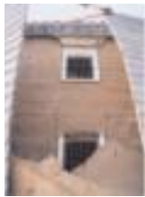
土蔵の被害状況。
