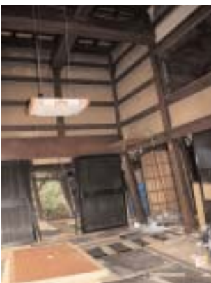
写真―2 柱の折損と傾斜
