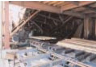
倒壊した製材所。
