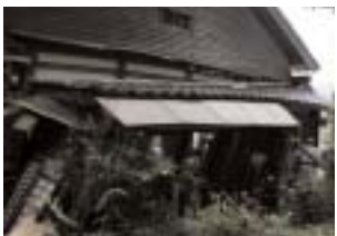
写真―3 下屋の脱落状況
