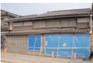
町家の被害状況。
